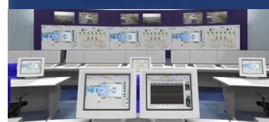
【水】上下水道監視 制御システム
