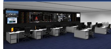
【電力】 系統監視制御システム
